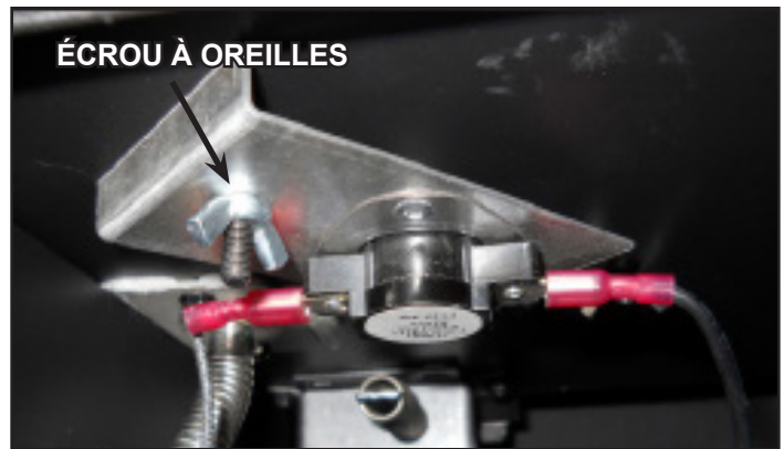
Figure 8.5 Interrupteur à capteur de température installé
